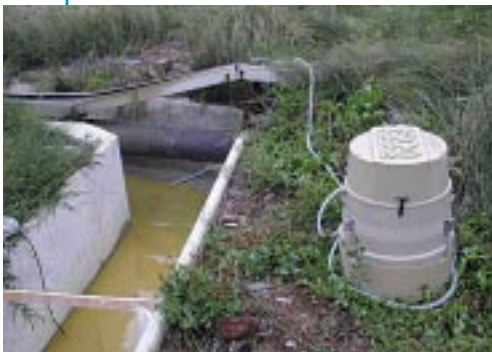
Etude hydraulique : entrée de la lagune (préleveur et débitmètre).
